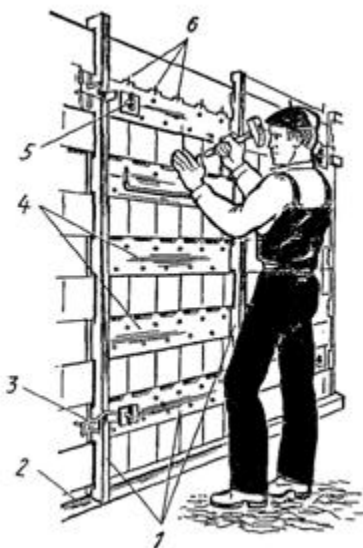
Рис. 102. Облицовка горизонтальными рядами с помощью шаблона: 1 - щит шаблона, 2 - опорный брусок, 3 - рейкодержатель, 4 - промежуточные рейки, 5 - опорным винт, 6 - стальные пластинки
